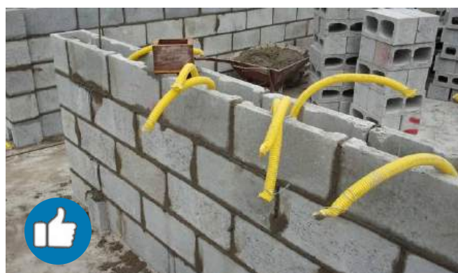
Conduítes e tubulação embutidas
