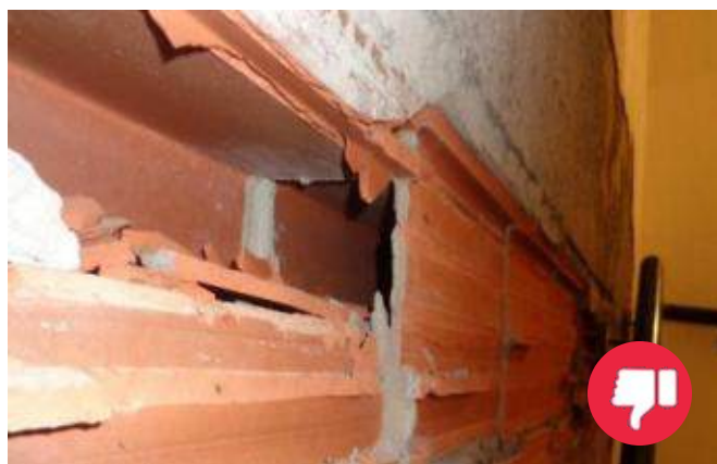
Falhas na execução do encunhamento de alvenarias
