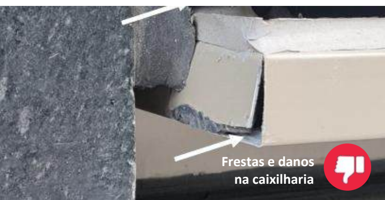
Frestas entre caixilhos, vigas e alvenaria
